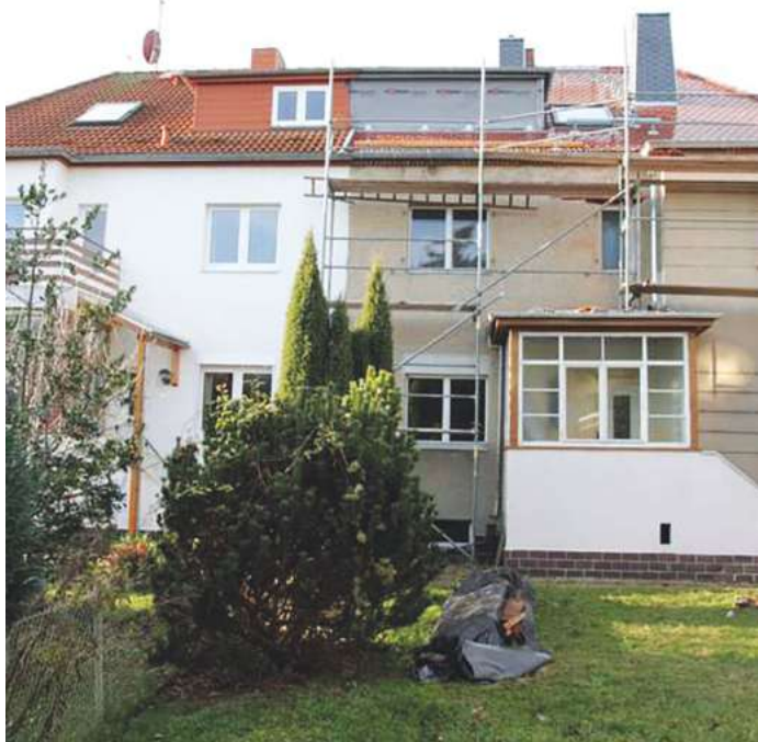
Laut einer aktuellen Verbraucherschutzstudie sind Baumängel auch in der Sanierung von Altbauten keine Seltenheit. Foto: djd/Bauherren-Schutzbund/Rosse
